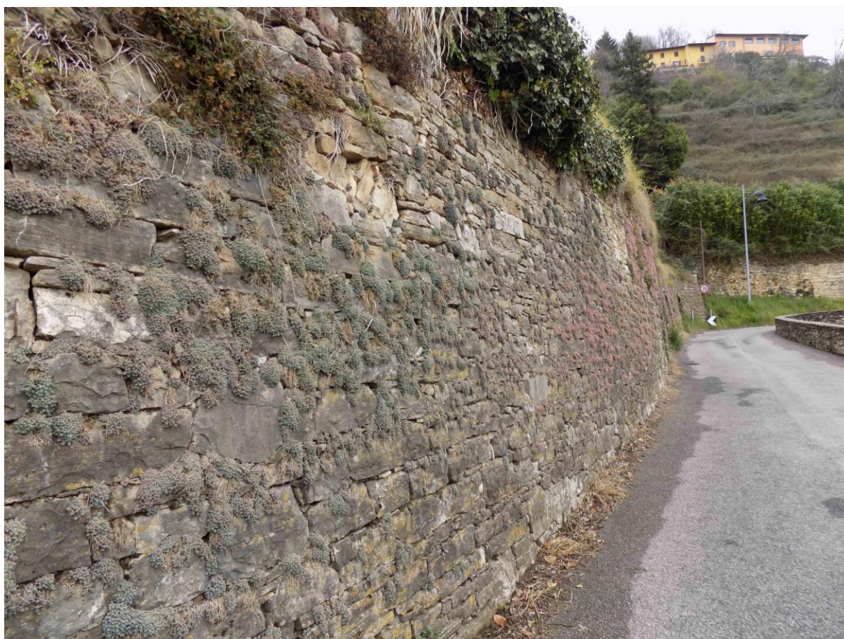
Muro di Via Fontana, tappezzato dalla Borracina cinerea.
